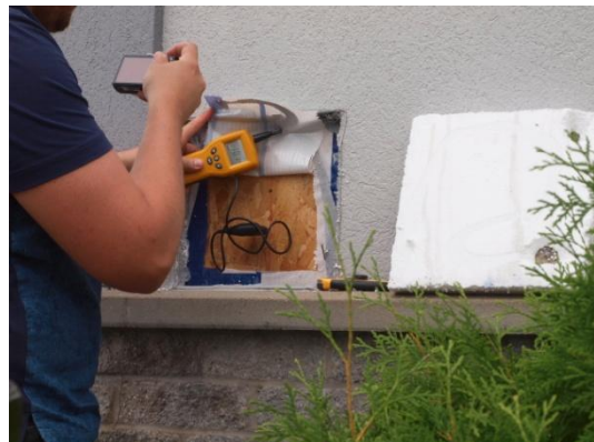
Fig. 3 Trous d'exploration et prise du taux d'humidité des panneaux intermédiaires.
