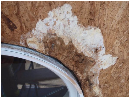
Fig. 5 Pourriture du panneau intermédiaire autour des ouvertures non protégées de solins flexibles
