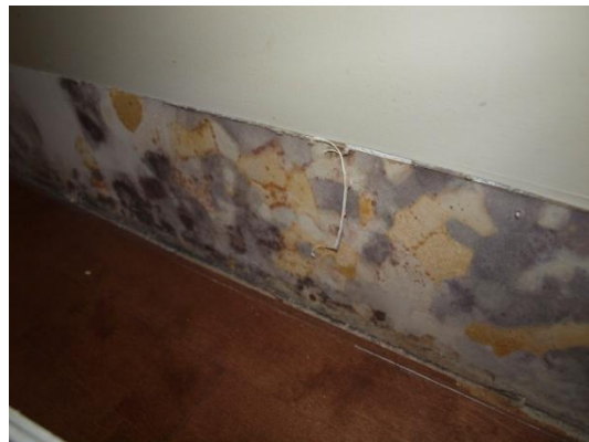
Fig. 7 Pourriture sévère du bas du mur dans une unité de copropriété due à la défaillance d'un mur à parement isolant
