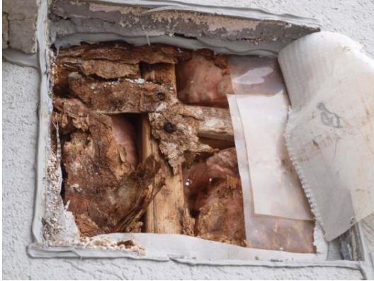
Fig. 4 Pourriture avancée du panneau intermédiaire
