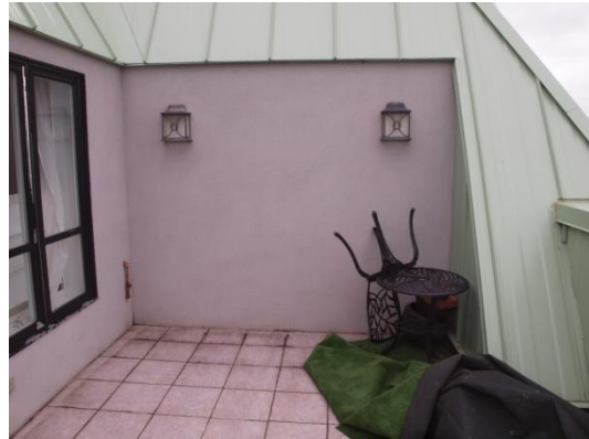
Fig. 6 Parement isolant en contact direct avec une surface susceptible d'être recouverte de neige (ici un toit-terrasse).
