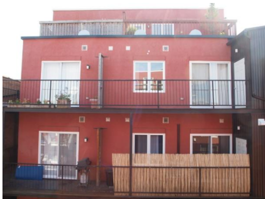
Fig. 1 Exemple de bâtiment recouvert de ciment-acrylique
